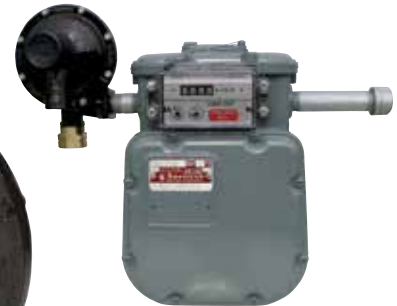
Colocado en el medidor de vapor
